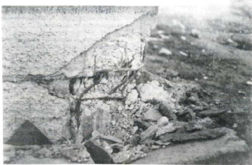
Figure 1 : Disposition déficiente des armatures longitudinales des poteaux ; les aciers sont pliés pour "récupérer" la variation de section du poteau entre un étage et l'étage immédiatement supérieur.
