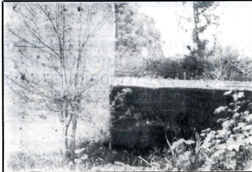
Figure 3 : Renversement d'un mur de soutènement suite à un ancrage insuffisant de la semelle de fondation et à l'absence de drainage derrière le mur.
